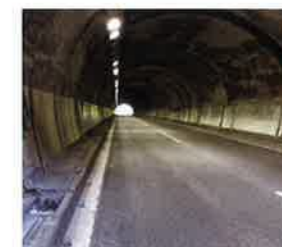
老朽化したコンクリート
