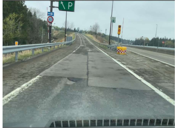
損傷した路面状況(妙高SA)
