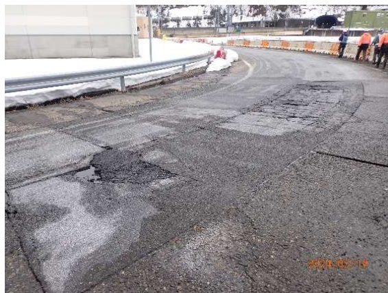
損傷した路面状況(土樽PA)
