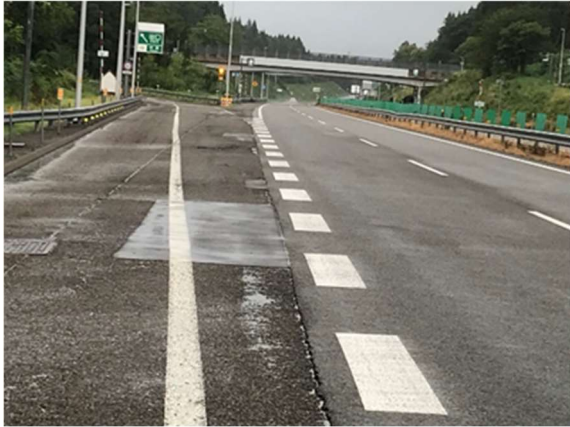
損傷した路面状況(中郷IC)
