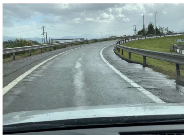
損傷した路面状況
