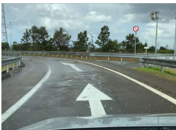
損傷した路面状況
